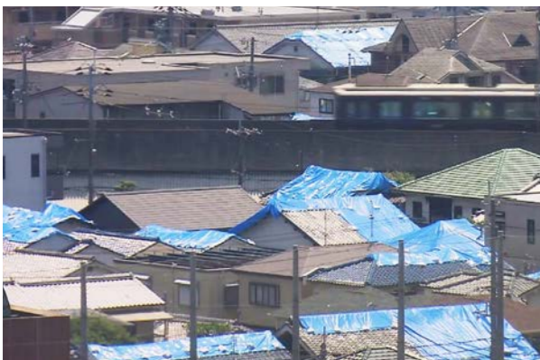
暴風で飛ばされ、ブルーシートで覆われた屋根
