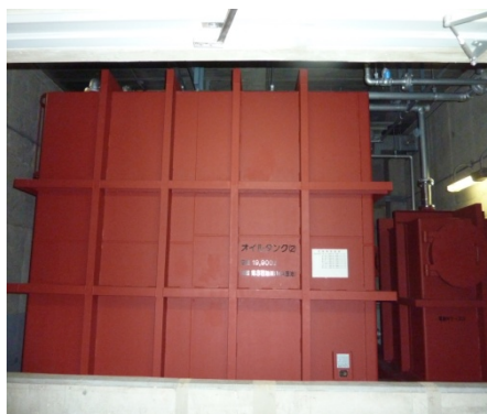
▲耐水性オイルタンク
